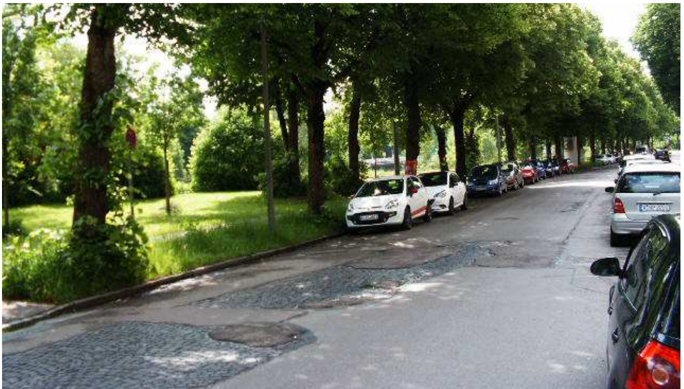
Wenn die Straßenschäden in der Hessenbachstraße repariert werden, sind sämtliche Bäume im schmalen Grünstreifen östlich der Fahrbahn gefährdet
